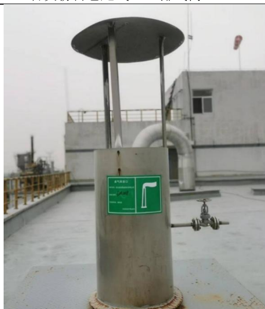
硫酸钠干燥废气G4-1排气筒DA008
