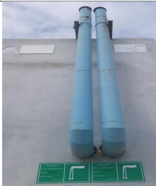
碳酸锂包装尾气G3-2排气筒DA025、DA026
