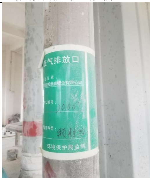
酸化熟料仓尾气G2-2排气筒DA007
