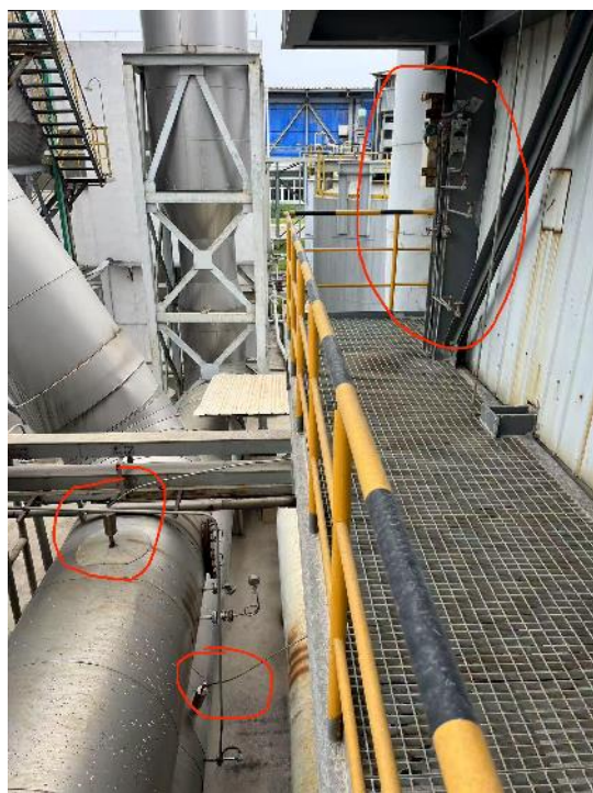
脱硫工序压差计（入口、出口）
