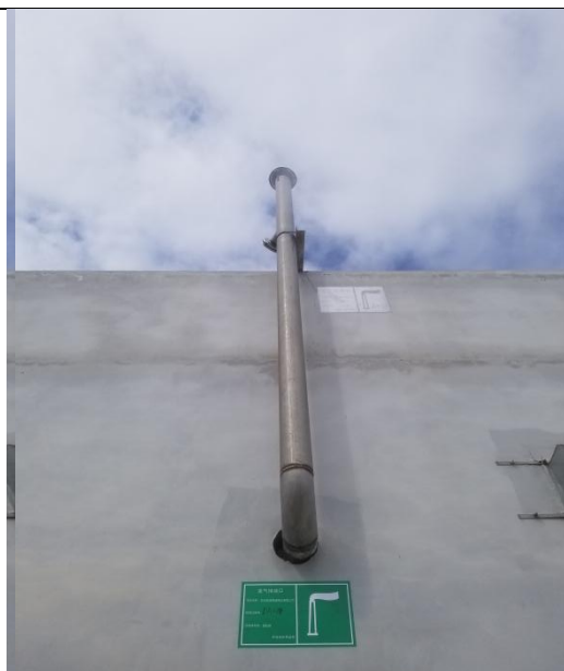
碳酸锂干燥尾气G3-1排气筒DA027
