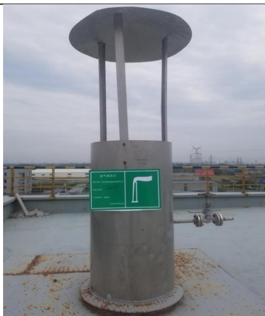
硫酸钠干燥废气G4-1排气筒DA020
