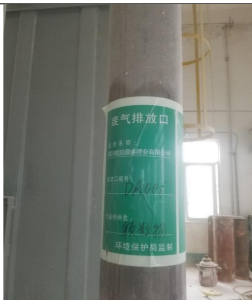
石灰粉料仓尾气G2-1排气筒DA006
