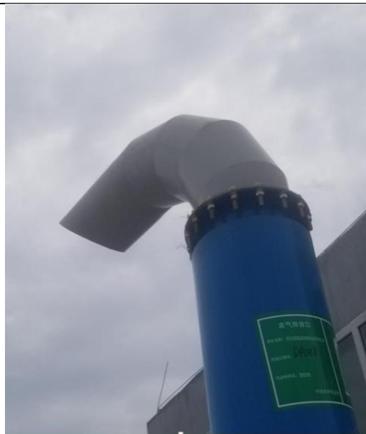
碳酸锂包装尾气G3-4排气筒DA023
